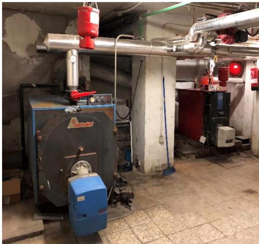
Antes – calderas de gasoil
