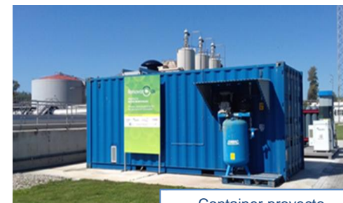
Container proyecto Renovagas
