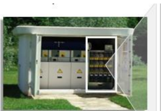
Centro de Transformación
