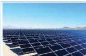
Centrale pilote PV Multi-Technologies (100Kw)
