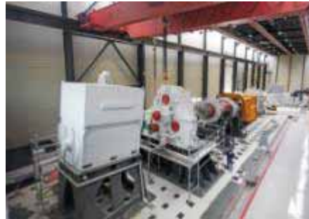
Banco de Ensayo de Tren de Potencia (5 MW)
